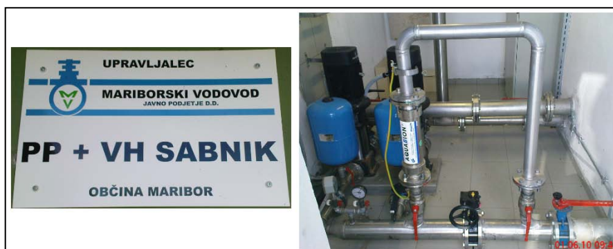
Slika 3-4: Prečrpalna postaja in vodohram Sabnik.
