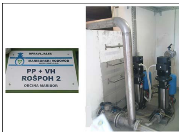
Slika 3-3: Prečrpalna postaja in vodohram Rošpoš 2.
